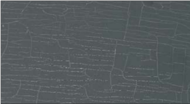
Das Gefüge ist durchgängig durch die UV-Strahlung geschädigt.
