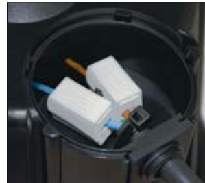
HelaCon Lux verbunden mit der Stromversorgung.
