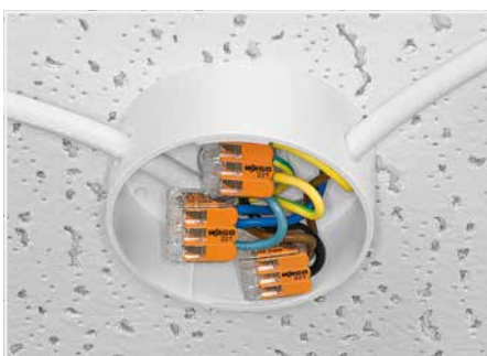
Leuchtenverteilung in Deckenbaldachin
