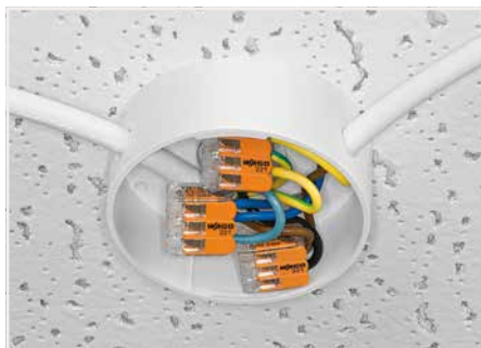
Leuchtenverteilung in Deckenbaldachin
