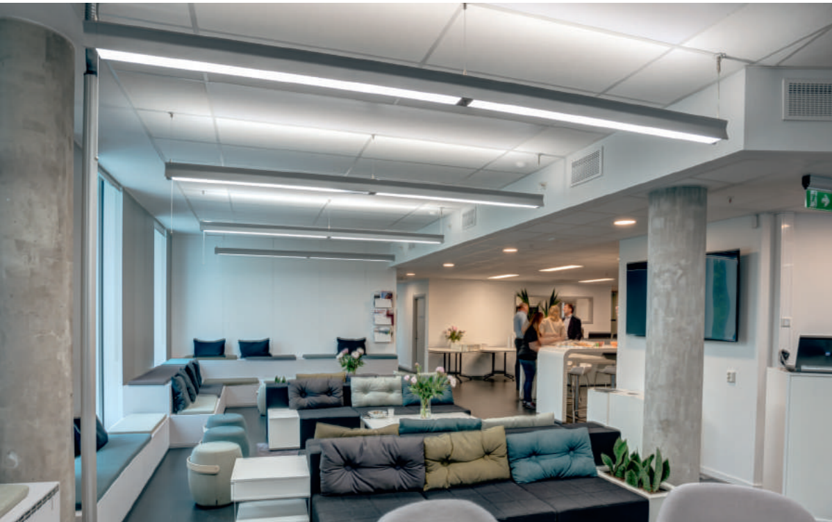
Im Abels hus wird eine Sonderversion der Glamox C56 Leuchte verwendet. Sie misst 2,40 Meter und ist damit doppelt so lang wie die Standardversion. Mit der Länge wächst die Flexibilität. Der Tageslichtsensor befindet sich in der Mitte und sorgt dafür, dass das Licht aus den Fenstern das Lichtmanagement nicht stärker beeinflusst als erwünscht.
