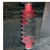
Sicheres Verhalten bei Kurzschluss
