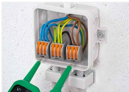
Prüfen der installierten Klemmen
