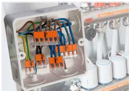
Verdrahtung feindrätiger Leiter in Installationsdosen bei Fußbodenheizung
