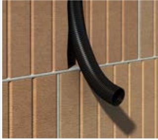
Mauerwerk mit Rohraustritt
