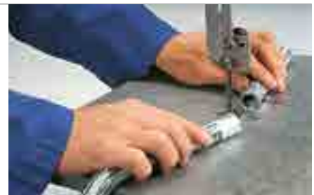
Saubere Trennung ohne Fasern durch die Umwicklung mit Metall-Klebeband Conduit ends are clean without splaying, due to adhesive tape binding
